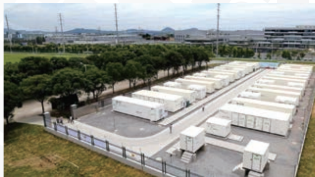
白色家电生产园区一、二期光伏发电站
